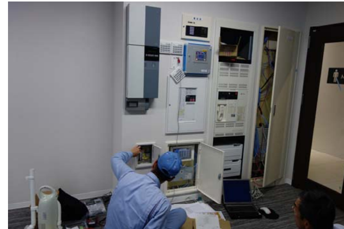
三菱電機の集中コントローラーにIDMの警報信号を入れる
